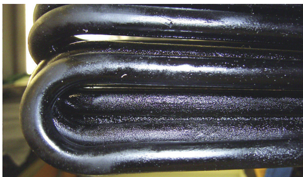
Ölalterungsprodukte auf Rohrbündel eines Ölkühlers
